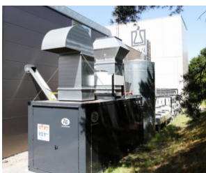
Centrale de cogénération
